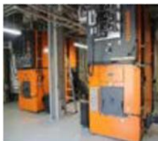
木質バイオマスボイラー
